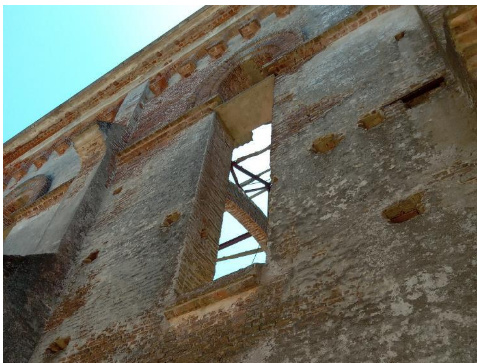
Figura 4 – Detalhe da fachada lateral da Igreja de Piria: desgaste do revestimento externo revelando as suas diferentes camadas. Fonte: Acervo de Marcela da Rosa Dias (2023).
