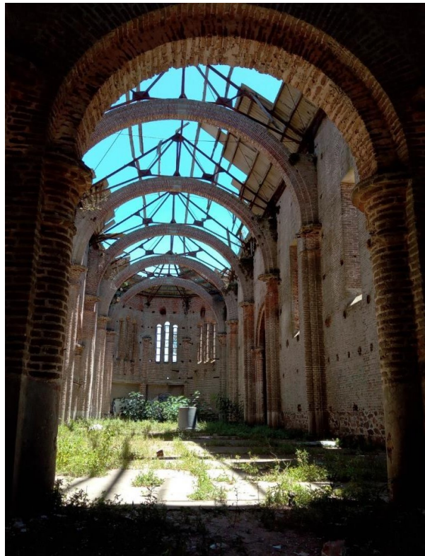
Figura 1 – Perspectiva do interior da Igreja de Piria: efeitos de luz e sombra decorrentes da perda da cobertura, presença de pátinas nas alvenarias e de vegetação. Fonte: Acervo de Marcela da Rosa Dias (2023).
