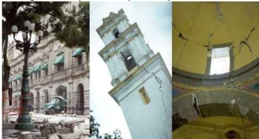
Figura 2. Daños provocados al patrimonio por el efecto telúrico
