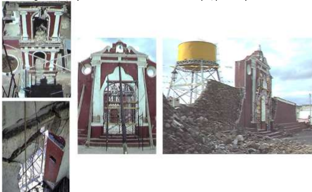
Figuras 3, 4, 5 y 6. Vista de los Deterioros en el Templo, portada y barda atrial
