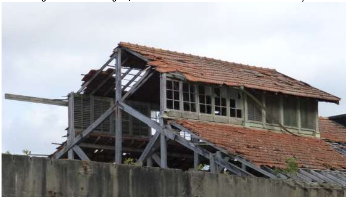
Figura 8: Cobertura original, com telhas francesas em total estado de deterioração.
