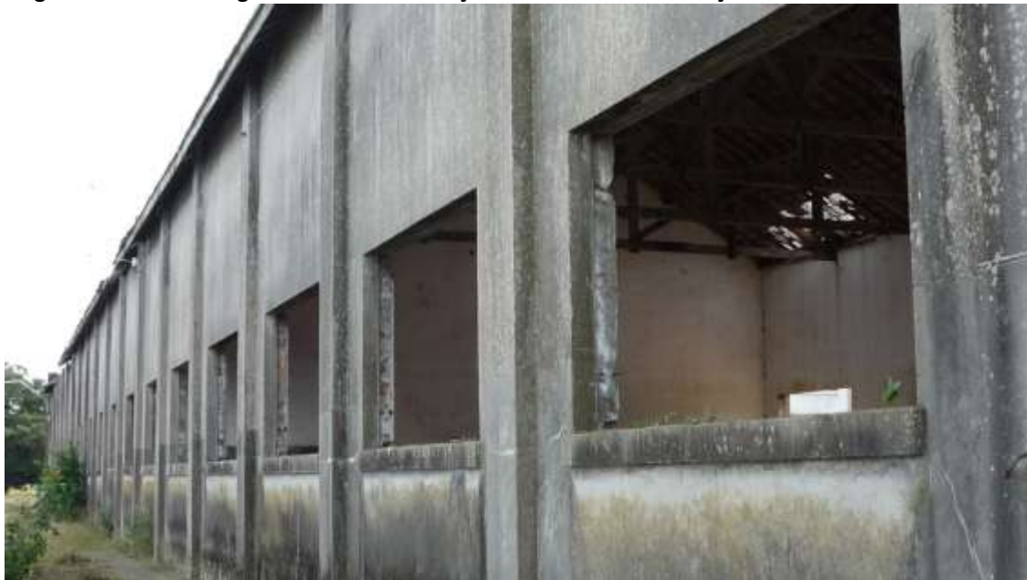
Figura 4: Prédio à margem do canal São Gonçalo. Continua sem utilização e em estado de abandono.
