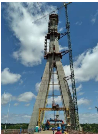
Imagem 05 : Ponte da Integração (Brasil/Paraguai), em adiantada fase de construção. Fonte: Cecilia Angileli, visita ao canteiro de obras em outubro de 2021
