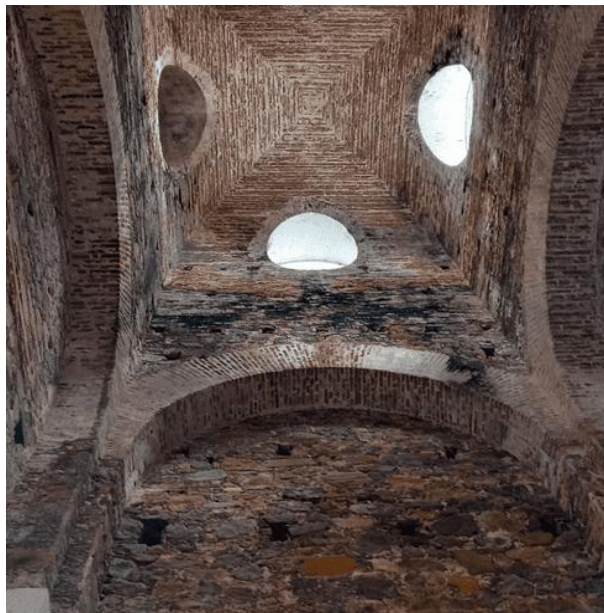
Figura 6: Materiais construtivos da parte interna do edifício da Estação de Cachoeira. Foto: Autores, 2023.
