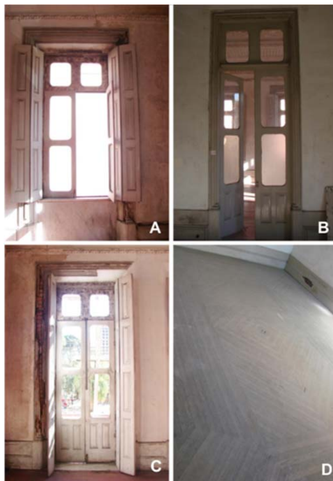
Figura 3. (A) Ventana externa. (B) Puerta interna. (C) Puerta externa. (D) Piso de tablas de madera.
