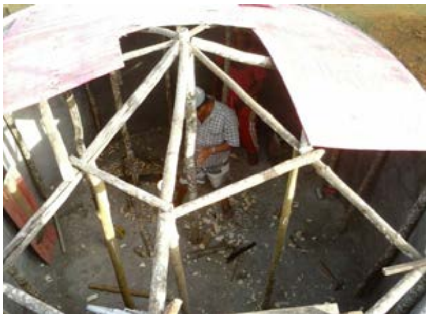
Figura 11 Estrutura sendo montada como suporte para fazer a cobertura do tanque Foto: AGUIAR, P. C. B. de. (2014).
