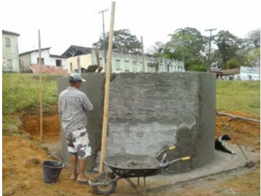
Figura 10 Tanque sendo rebocado em suas laterais Foto: AGUIAR, P. C. B. de. (2014).
