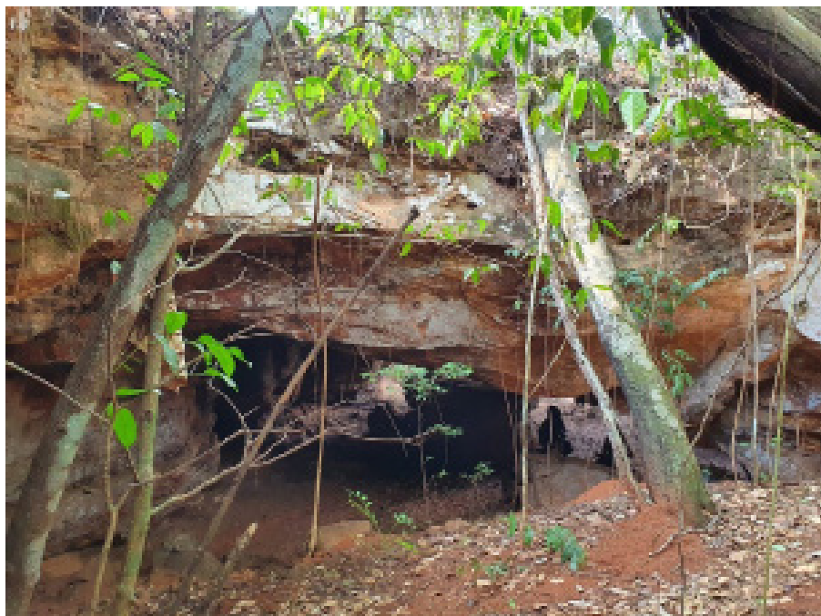
Figura 12: Vista do fundo que entrou em colapso, em direção a boca da gruta
