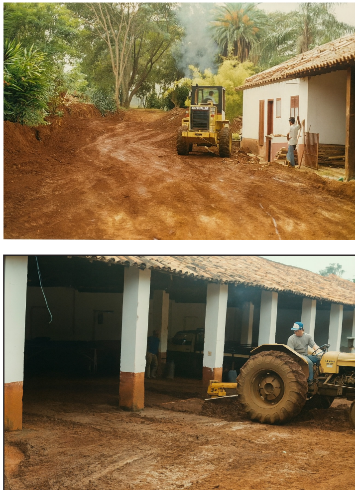
Figura 3: Execução das obras de execução na área externa da antiga senzala. Imagens com revelação datadas respectivamente em 03/07/1998 e 15/01/1997. Acervo do Centro de Estudos, Pesquisa e Educação da Fazenda do Pinhal.
