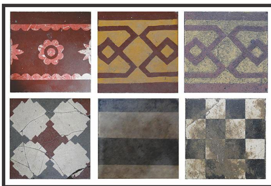
Figura 8. Patologias encontradas nos ladrilhos hidráulicos de Cachoeira - BA: 1) Mancha feita com por uso de cera vermelha; 2a) Superfície lisa; 2b); Superfície porosa; 3) Trincas e fissuras; 4) Manchas e 5) Opacidade. Fotos: Caroline Pereira Teixeira e Aline Marçal Santos, 2015.
