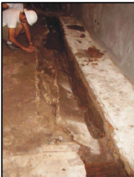
Figura 07: Desmoronamento de piso. Fonte: Acervo do IMP
