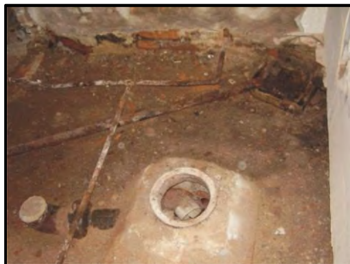
Figura 06: estruturas de encanamento
