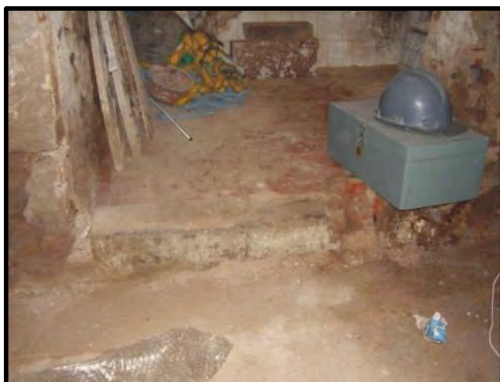
Figura 05: banheiro antes da intervenção Fonte: Acervo do IMP
