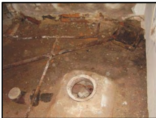
Figura 06: estruturas de encanamento Fonte: Acervo do IMP
