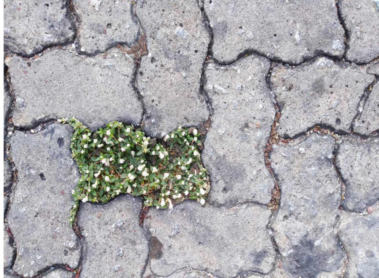
Figura 5 - Fissuras e perpétuas ( Gomphrena sp.) em calçada da Vila União, em Goiás (GO). Fonte: o autor, agosto de 2022.
