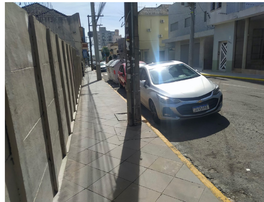
Figura 1 - Muro do estacionamento na rua Silva Jardim antes da intervenção, início de dezembro de 2023. Fonte: Acervo das autoras, 2023.
