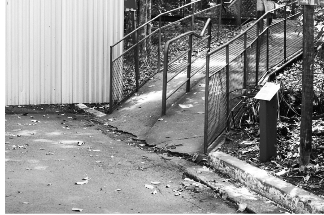
Figura 6 – Percurso no interior do Parque do Ingá, dia 28/03/2025. Tapume impedindo percurso/trilha interna do Parque, indicando seguir pela trilha metálica ao lado (percurso em frente impedido). Dos autores.
