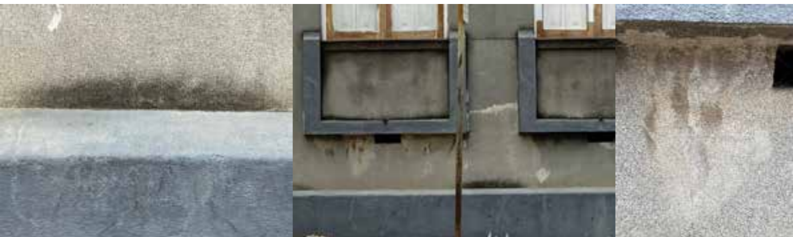
Fig. 26 – Manchas. Edificação “32-1151”. Fig. 27 - Fissuras e trincas. Edificação “32-1151”. Fig. 28 – Eflorescência. Edificação “32-1151”. Figura 29 - Manchas. Edificação “194-1644”. Fig. 30 – Aplicação de outro material. Edificação “194-1644”. Fig. 31 – Fissuras e trincas. Edificação “194-1644”. Fonte: Autora, 2021. Quadro 3 - Quadro de resultados do mapa de danos da edificação “194-1644”. Fonte: Autora, 2022.
