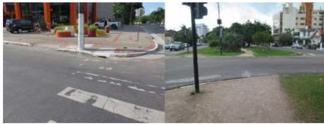
Figura 10: À esquerda, faixa deslocada da rampa e à direita, faixa apagada localizada à frente do percurso, jogando o pedestre para fora do trajeto. Fonte: Autores, 2019.
